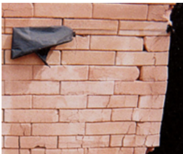
Figura 6 – Manifestação patológica em alvenaria de blocos de solo-cimento, originada por contração e expansão dos tijolos.
